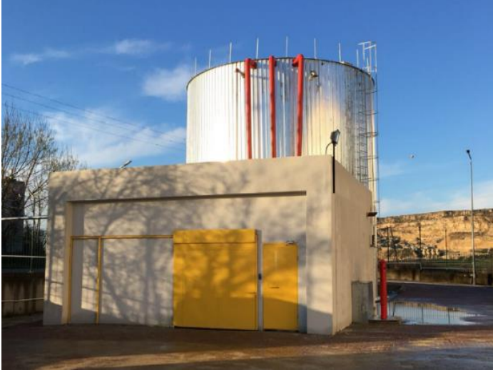
Iron Mountain Türkiye tesislerindeki yangın su tankı
